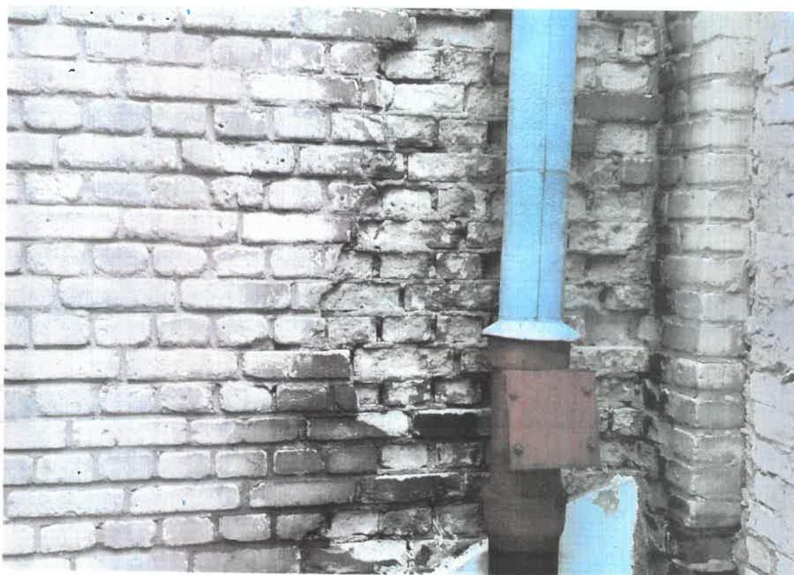
Fot. 2 Uszkodzenia warstwy licowej wskutek nieszczelności orywnowania Segment „d”, narożnik północny. Bez istotnego wpływu na nośność konstrukcji.
